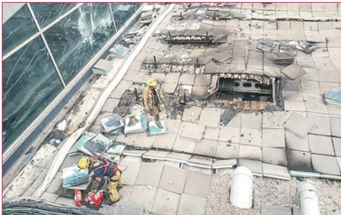
Así quedó la techumbre de la terminal tras el incendio.
