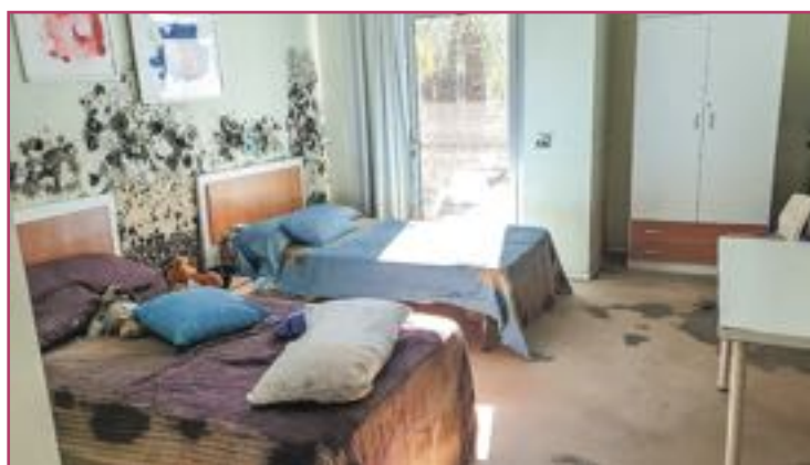
Estado en el que quedaron los dormitorios de la Residencia Oriol.
