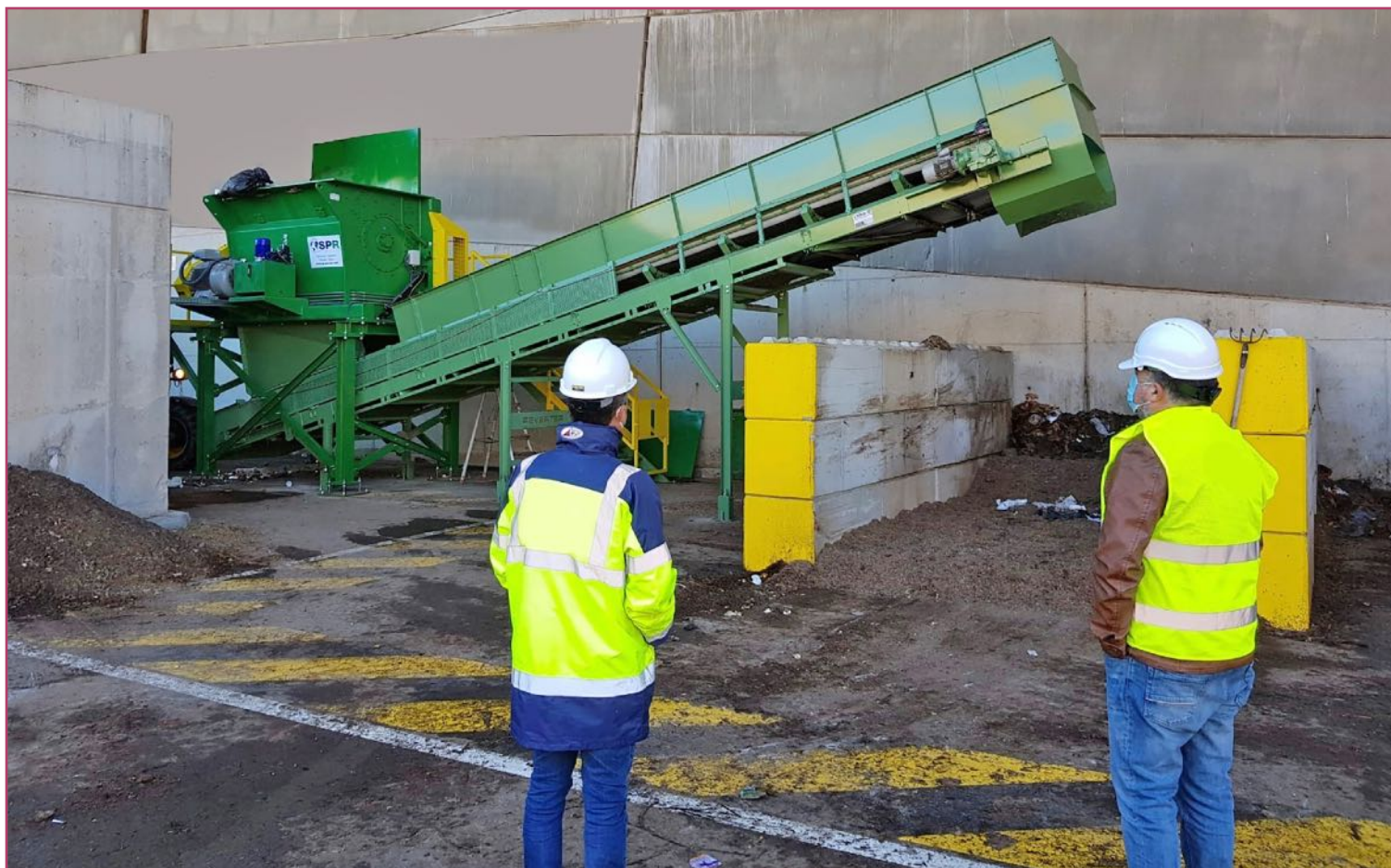
Zona de planta específica de residuos orgánicos recogidos selectivamente.
