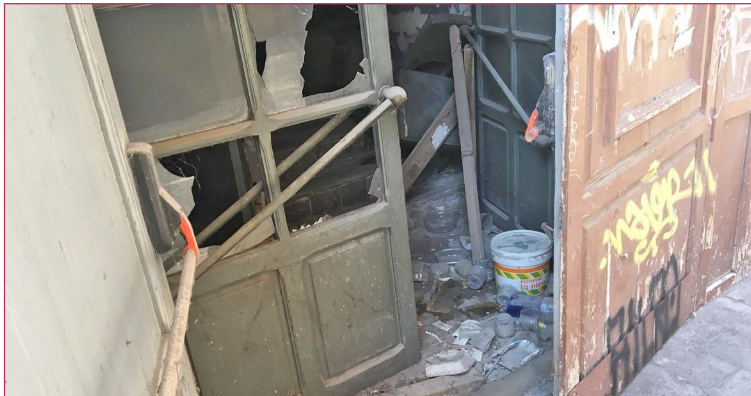
El Cine Ideal presenta actualmente un estado deplorable por su nulo mantenimiento.
