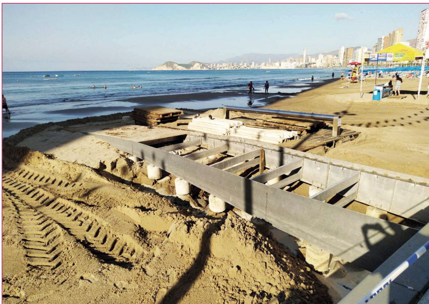
Imagen de los desperfectos causados por la lluvia en Benidorm.
