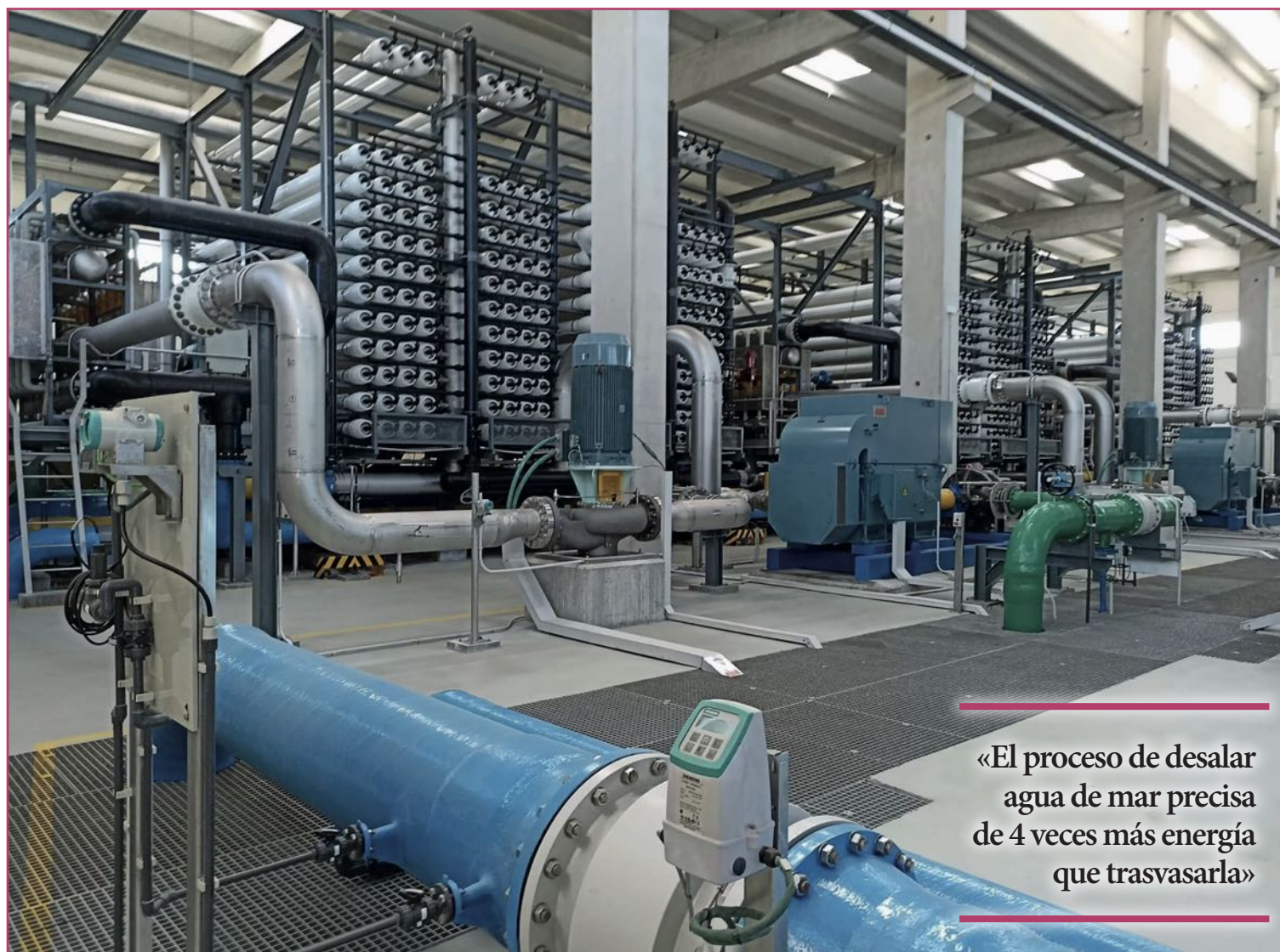
Planta desaladora de Mutxamel.
